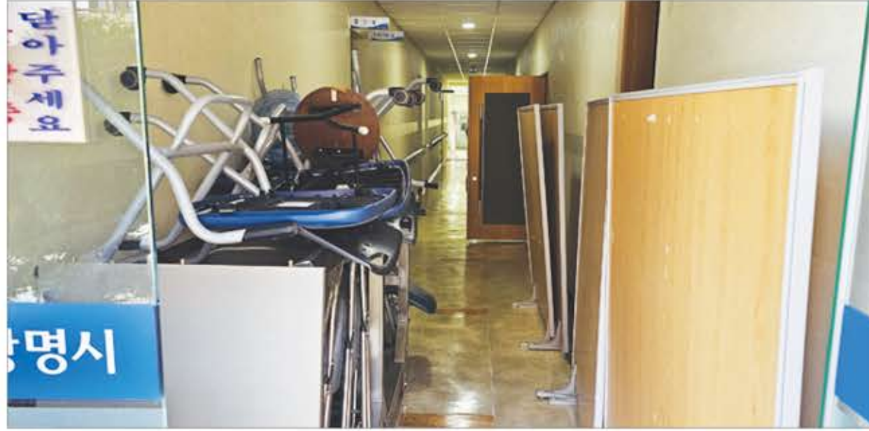
광명시청 제1별관으로 이어지는 통로에 의자등 각종 적치물을 쌓아 두고있어 비상상황이 발생할 경우 대형참사가 우려되고 있다. <사진·정성업 기자>
